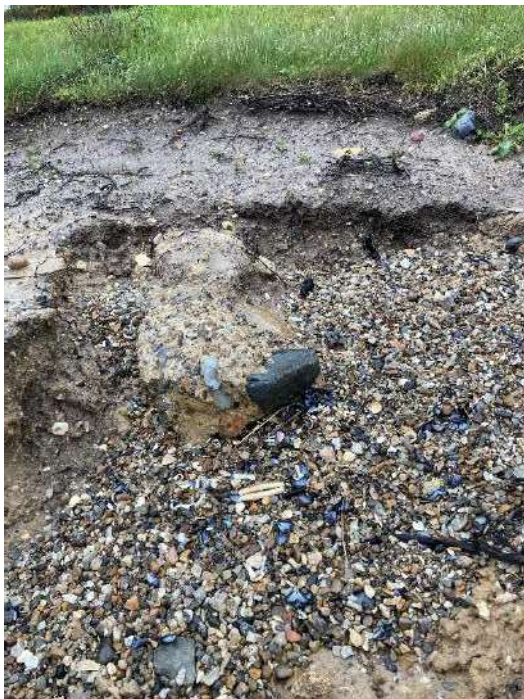
Figur 7 Beton med asfaltklump.
