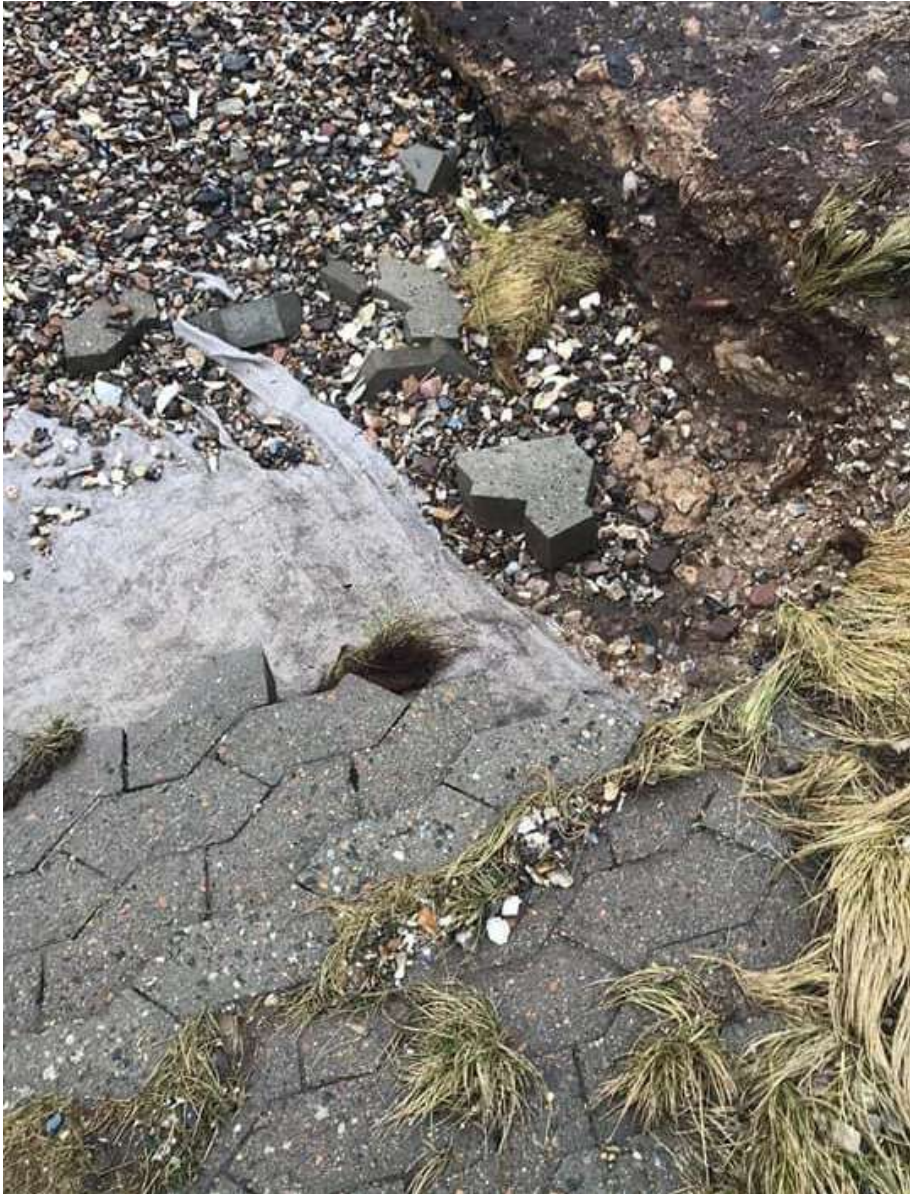
Figur nr. 3 Fotos der viser akut erosion i vinteren 20/21. FotoTaget af Kyst-havneviden den 20. maj 2021 i tidsrummet 13:45 - 14:15. Data til foto indeholder gps data, som kan fremsendes ved efterspørgsel.
