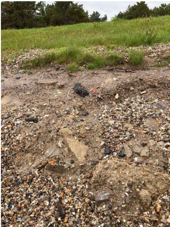
Figur 5 Diget, der eroderer. Byggeaffald, her beton og asfalt iblandet jorden.
