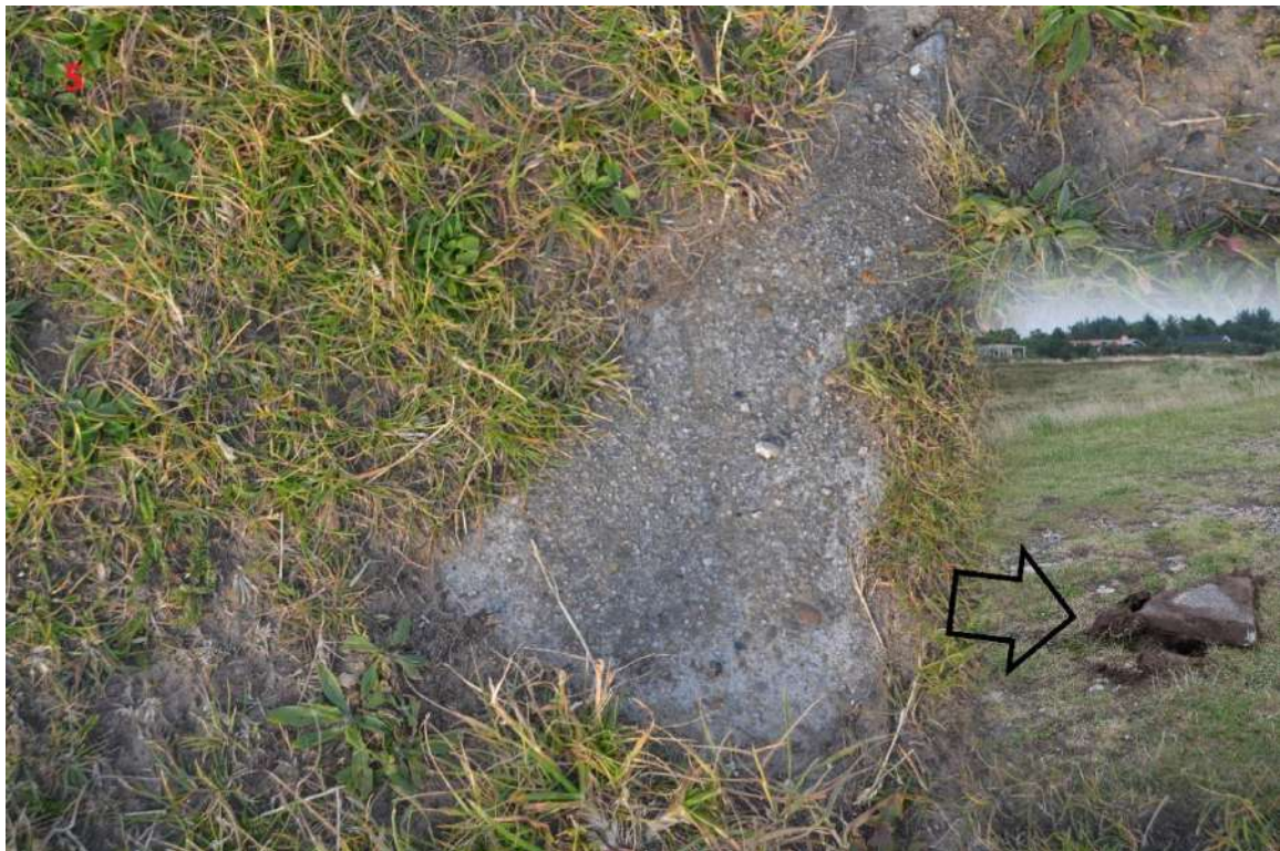
Endnu et stykke beton på digekronen.
